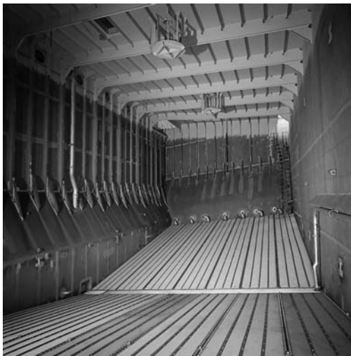
(Fig. 3 IBAU fluidisation system)
