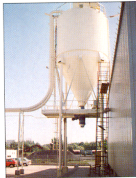
The buffer silo.
